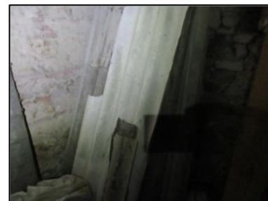
Traces d'attaques de termites souterrains
