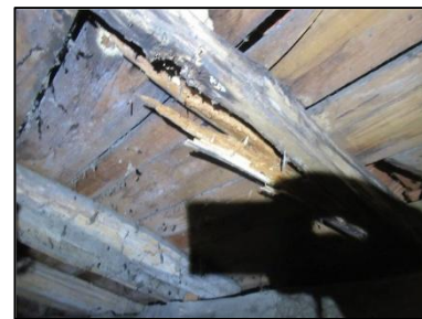
Charpente : éléments défectueux
