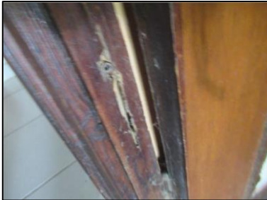
Trace d'attaque de termites souterrains
